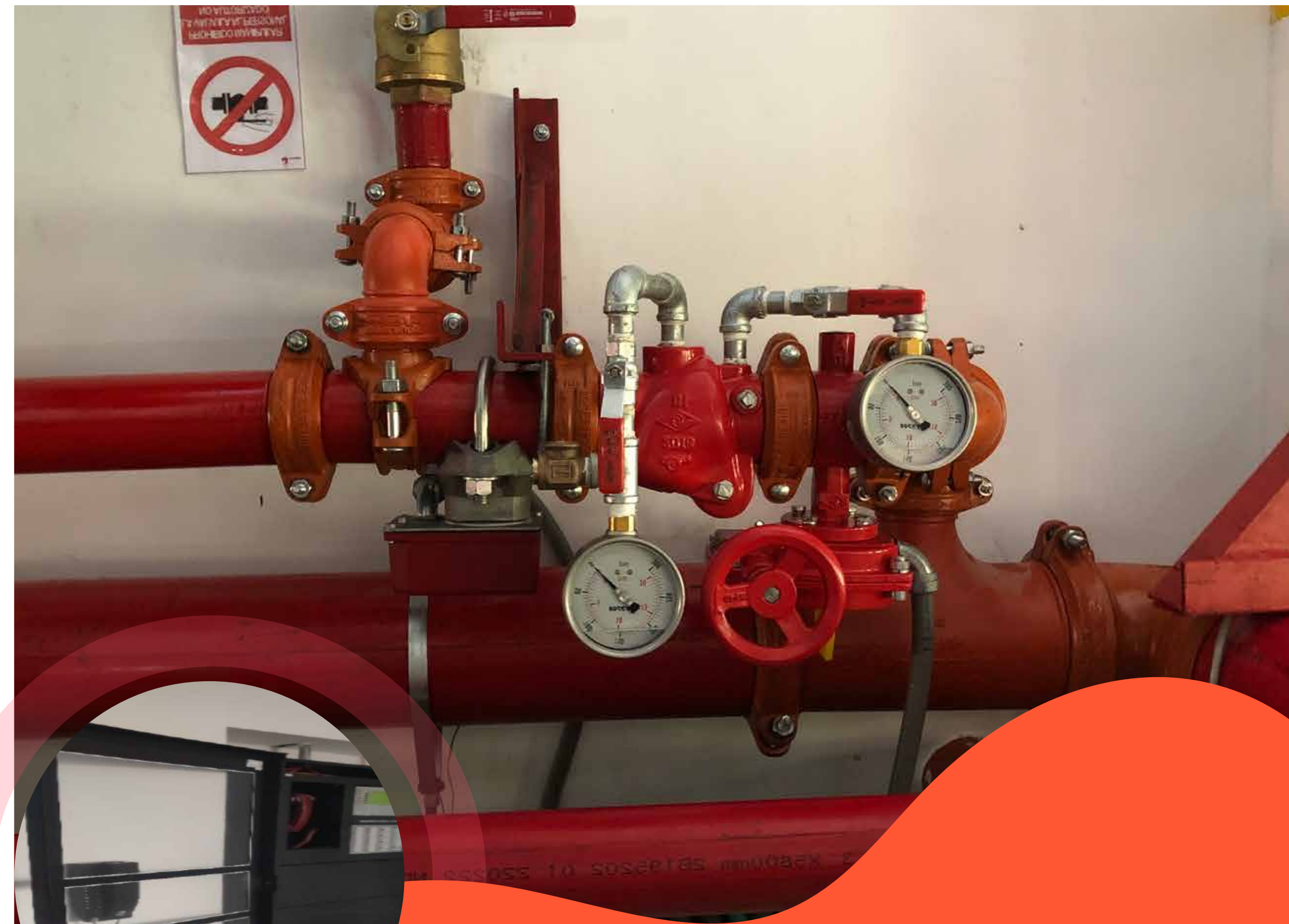
Sistema Red Contra Incendios HUBU
